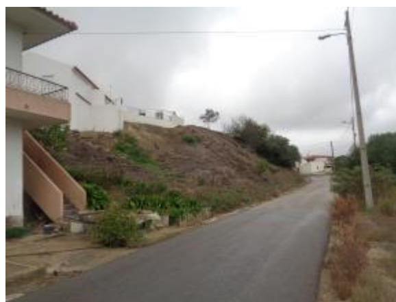
Foto 1 - Área urbana sem confluência com área florestal, com remoção quase total de todos os arbustos, e aplicação generalizada de herbicidas expondo o solo à erosão e consequentemente colocando a habitação em situação vulnerável.
