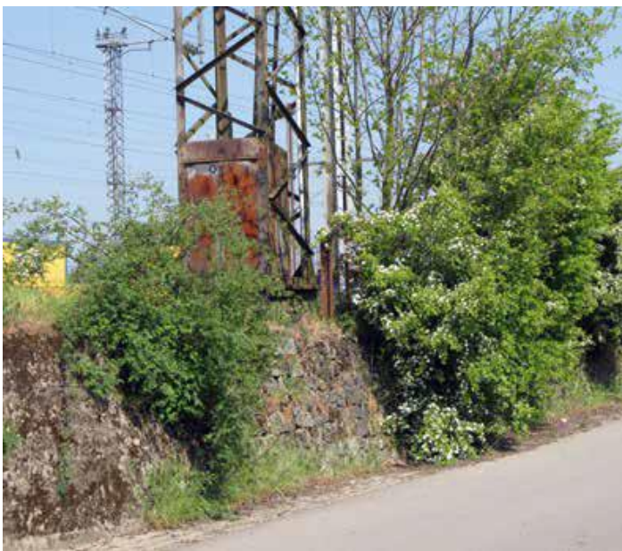
Foto 11: Muro com vegetação lenhosa.
