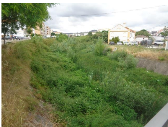
Foto 1 - Aspeto geral em 19 de junho de 2019, com indícios de utilização de herbicidas no topo do talude.
