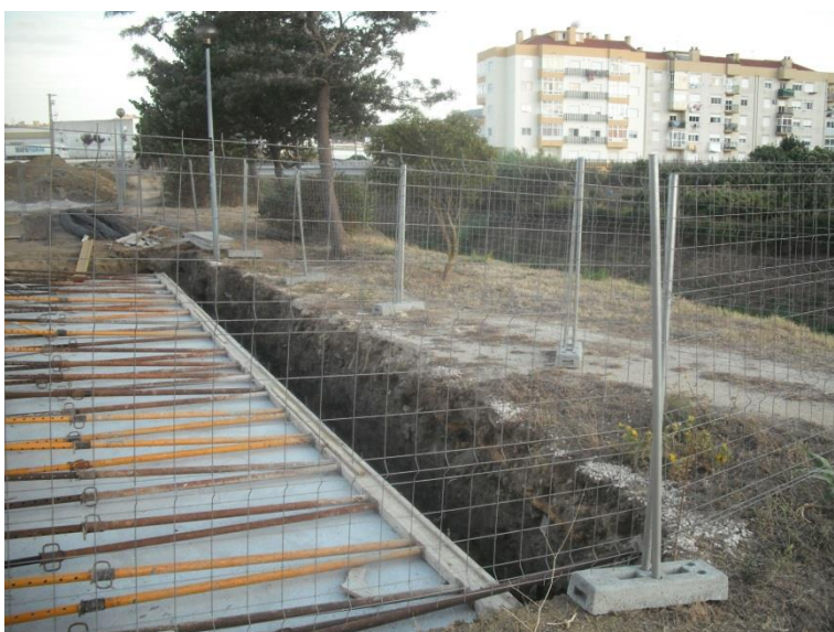
Foto 6 – Início de construção a 3 – 4 metros da margem do rio
