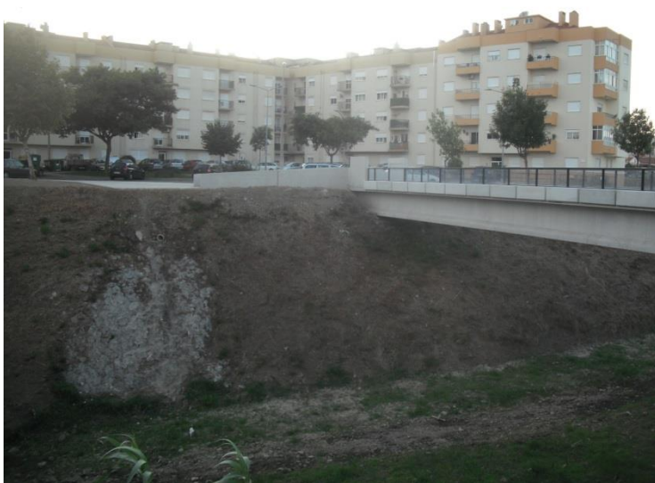
Foto 5 – Despejo de argamassa de cimento na margem
