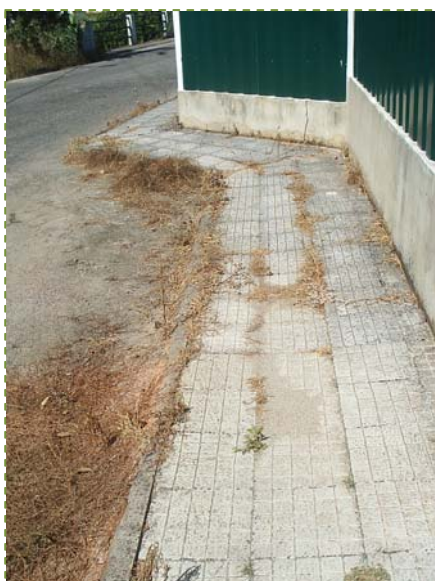
Figura 3 - Exemplo de local onde poderia ter sido utilizada a monda térmica, mas ao invés foram usados herbicidas.
