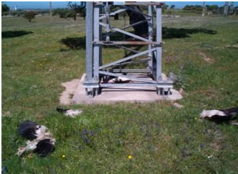
Fig. 22 – Aves electrocutadas num poste de média tensão
